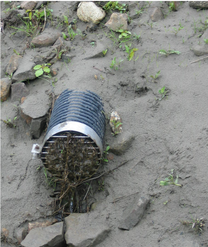
Photo 3 : Grille partiellement obstruée Source : Mikael Guillou (MAPAQ)
